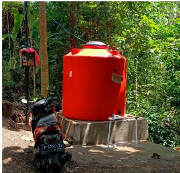
Gambar 4 Instalasi Tandon Air
